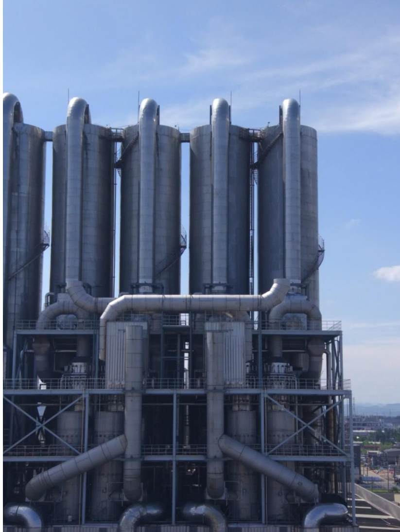
喷塔尾气回用装置现场图
