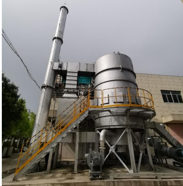
RTO 废气处理设施
