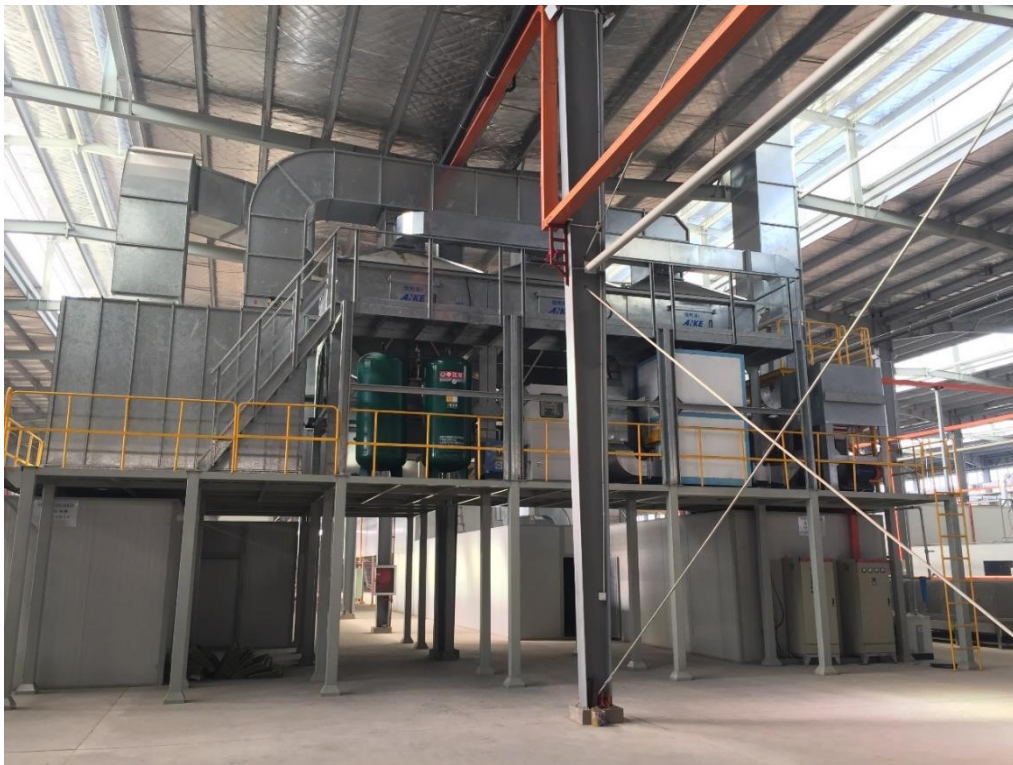
废气处理设施
