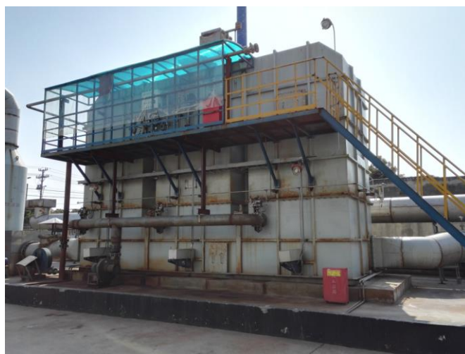
RTO 装置现场图
